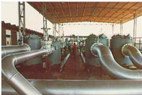
Sistema de mistura em linha (Skid Mounted) Refinaria de Paulínia - SP
